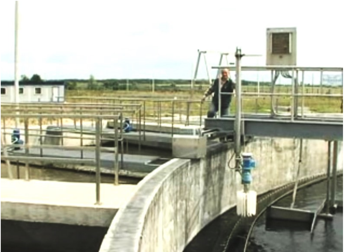
Kläranlage in Gusew.
