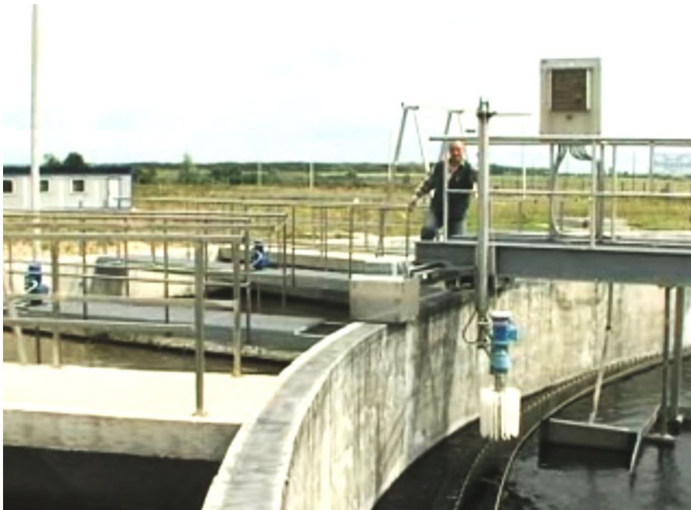
Kläranlage in Gusew.
